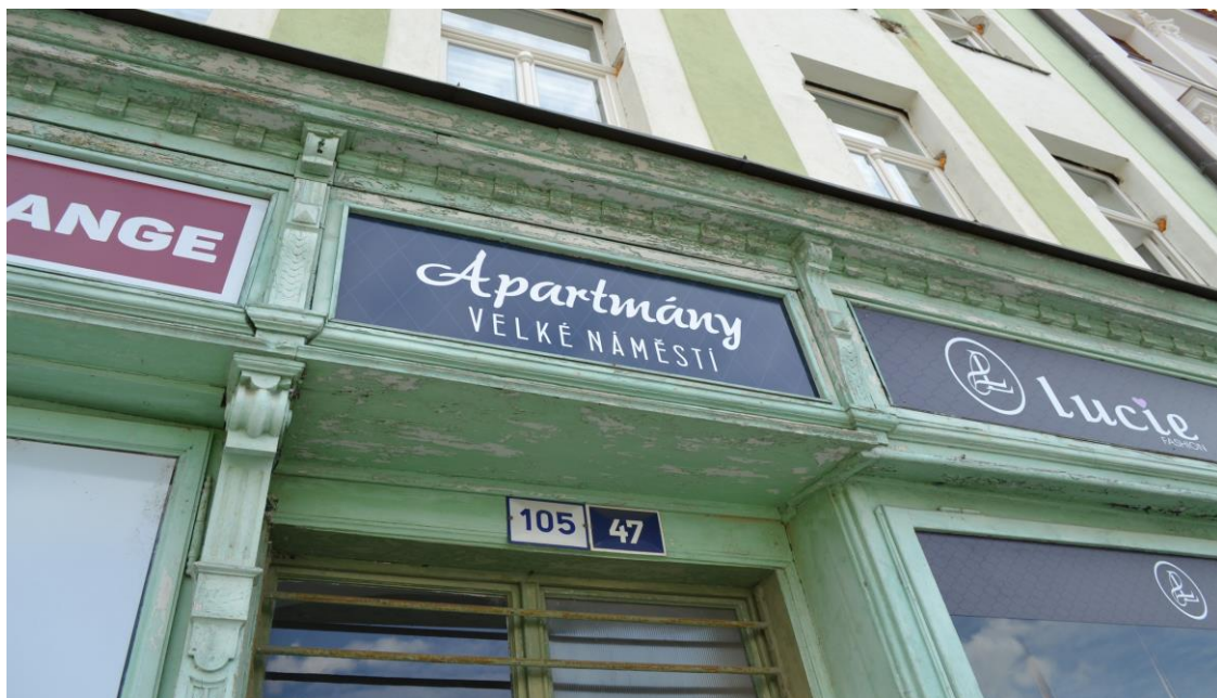
Současný stav horní konstrukce výkladců s reklamními štíty
