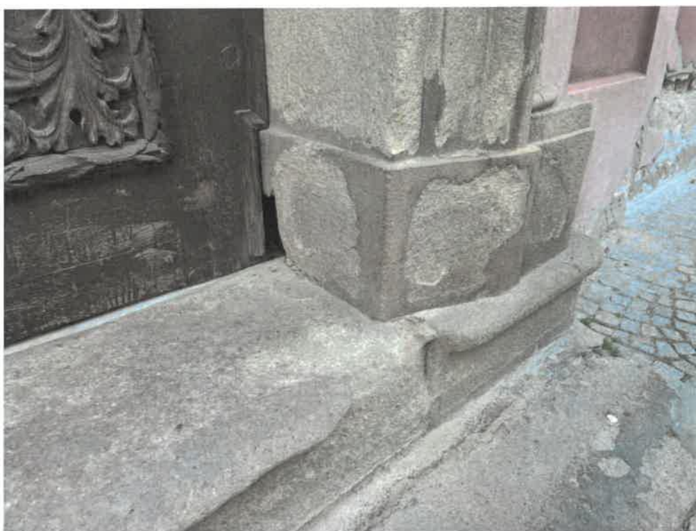
Detaily soklových částí ostění – četné vysprávkky a mechanické defekty způsobené zasolením a běžným provozem
