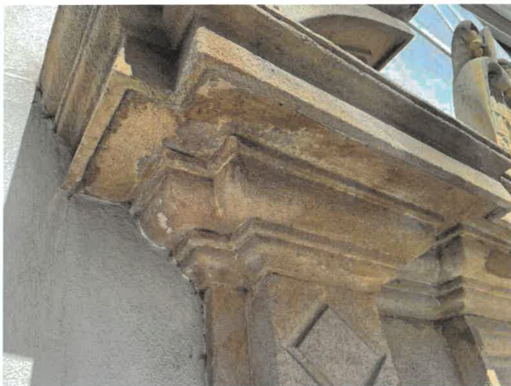
Detail pohledu římsy frontonu – lokální koroze ploch pohledu zapříčiněná kondenzací vody a tvorbou krust
