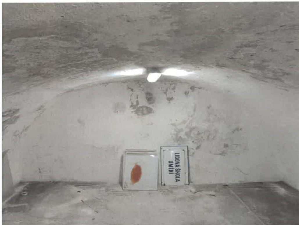
Fotografie před a po provedení sanačních prací - po otlučení omítek v roce 2021 Kanovnický dům, ul. Jánská 28/8, na pozemku st. p. č. 247 v katastrálním území Kroměříž, rejstříkové číslo kulturní památky č. ÚSKP 21246/7-6009
