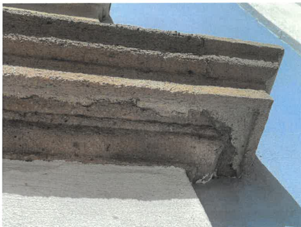
Detail pohledu přímé římsy portálu s viditelnou povrchovou korozí a krustou
